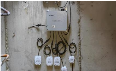
項目 5：電纜井環境監測
