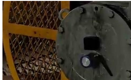
項目 4：工廠發電機溫度監測
